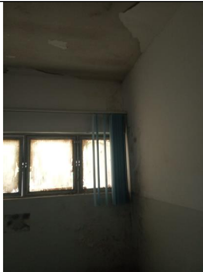
Teto da sala de Ginecologia.
