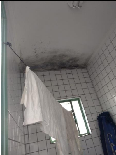
Umidade no teto causada por vazamento no telhado.
