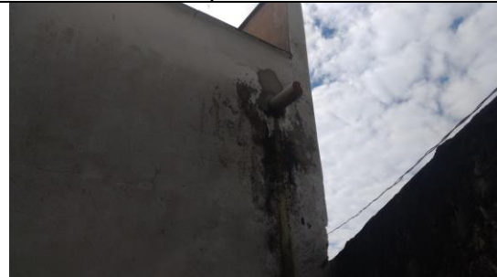
Tubulação pluvial na sala de agentes que será adequada para afastamento.
