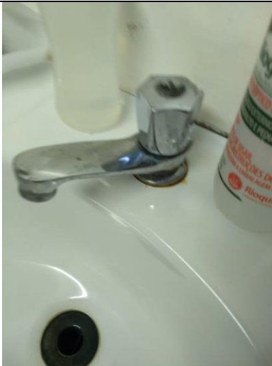
Torneira a ser trocada na sala de odontologia.
