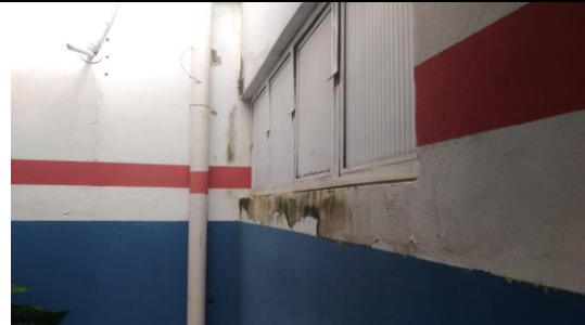
Janela a ser trocada, face externa da sala de ginecologia.
