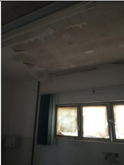
Teto da sala de Ginecologia.
