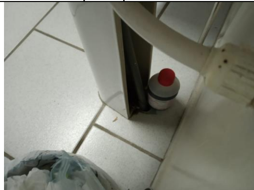
Tubulação desencaixada que causa mau cheiro nos lavatórios
