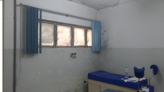
Umidade nas paredes da sala de Ginecologia e janela danificada a ser trocada.
