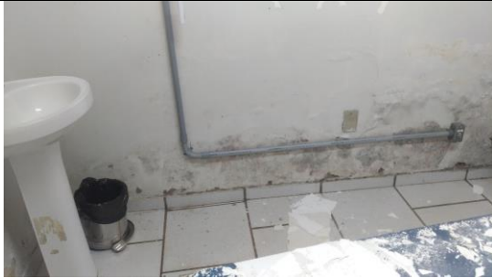
Umidade nas paredes da sala de Ginecologia.
