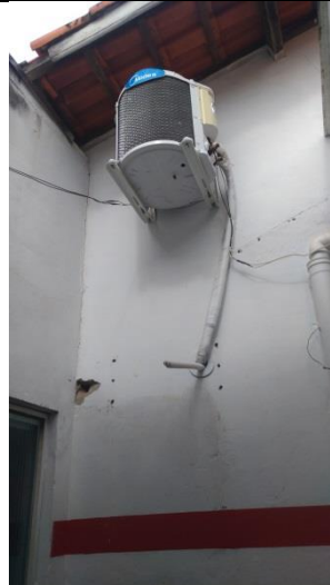
Dreno de Ar Condicionado a ser instalado e orifícios a serem preenchidos.
