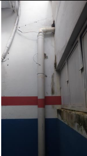
Instalação pluvial no fosso a ser adequada.
