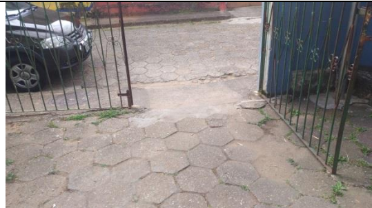
Portão que receberá pintura e entrada a ser regularizada para acessibilidade.
