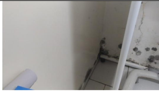
Parede da sala de odontologia onde será realizado tratamento e revestimento cerâmico.
