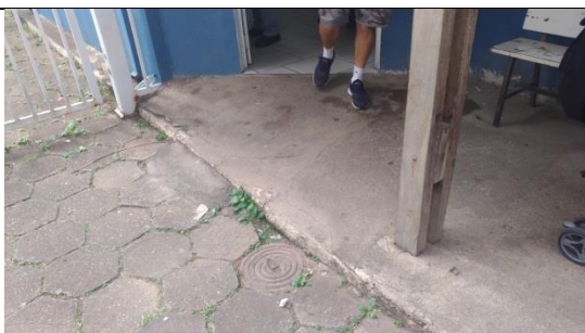
Entrada a ser regularizada com rampa de acessibilidade.
