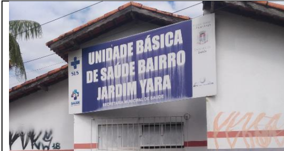
Placa a ser Substituída.
